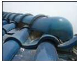
▲面戸のモルタルの割れ
